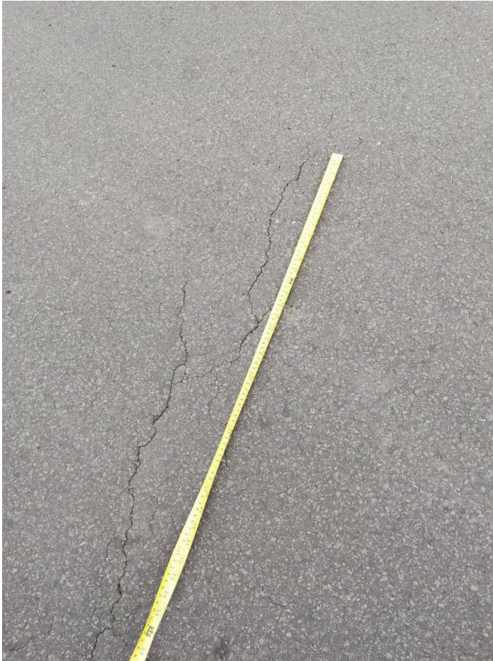
Medición de longitud de la fisura
