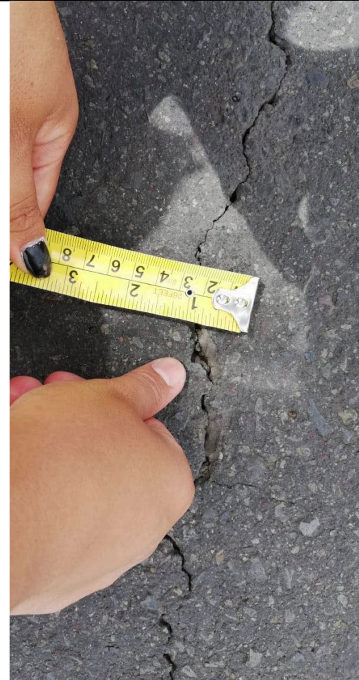
Medición del ancho de la fisura
