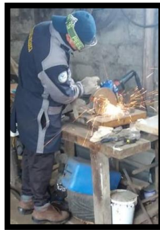
Figura 3-5: Corte de la Platina de 750 mm en secciones de 21 mm Fuente: Autor
