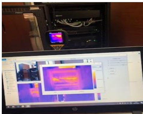
c. Captura de las imágenes para el reporte termográfico.
