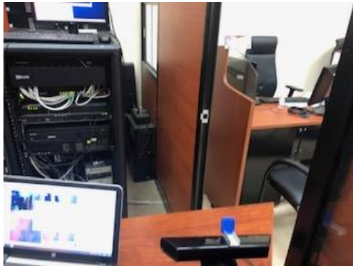
c. Captura de las imágenes para el reporte termográfico.
