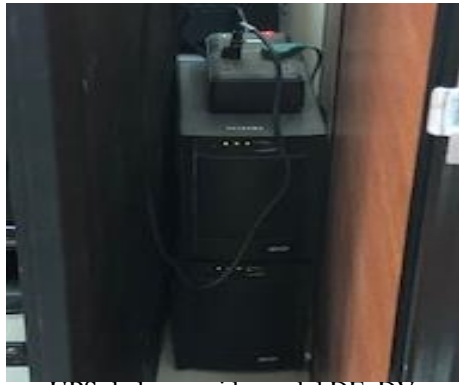
a. UPS de los servidores del DEaDV.
