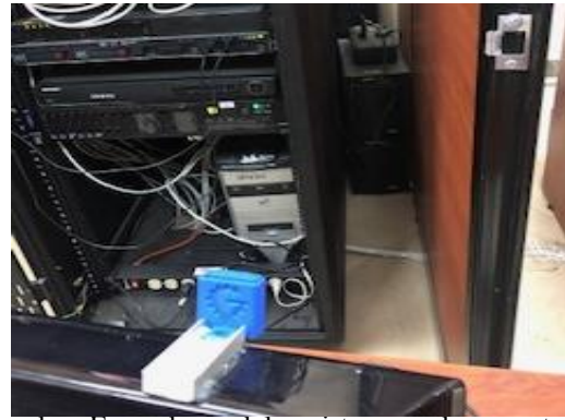
b. Encuadre del sistema de control termográfico 3D.
