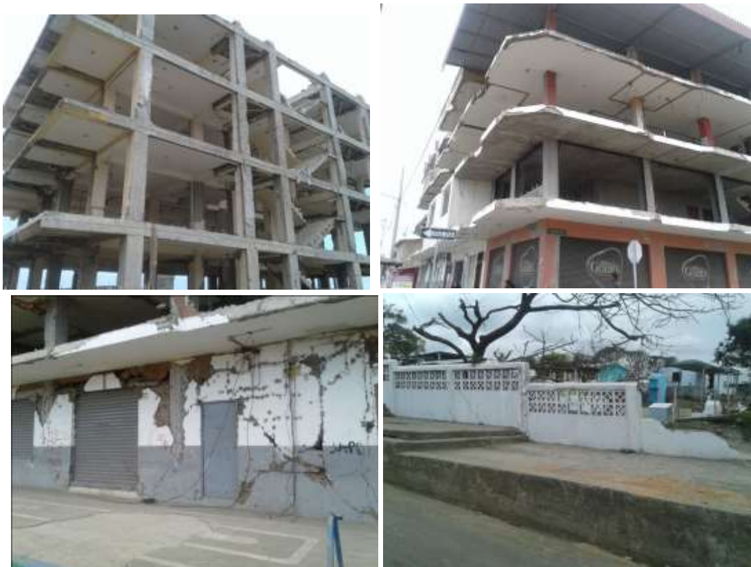
Imagen N°17: Estructuras afectadas Fuente: Investigador
