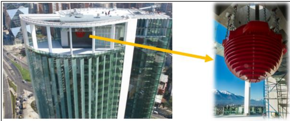
Fig. 17 Amortiguador de masa sintonizada instalado en el nuevo edificio de la Cámara Chilena de la Construcción
