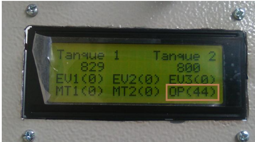
Figura 4. 57: Sistema Detenido-Falla Sensor Uno.
