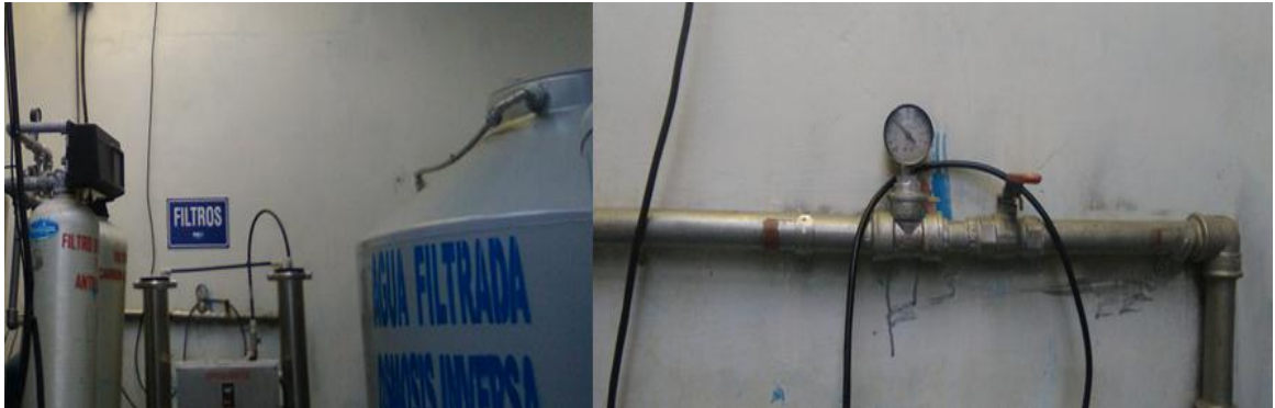
Figura 4. 29: Tubería deteriorada sección 3.
