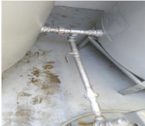
Figura 4. 27: Tubería deteriorada sección 2.
