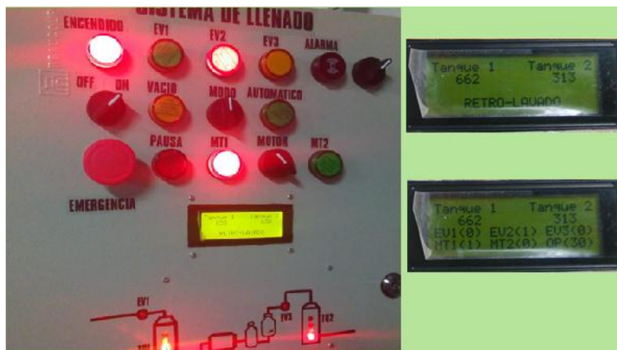
Figura 4. 55: Proceso de retrolavado de los filtros de arena-antracita y carbón activo.
