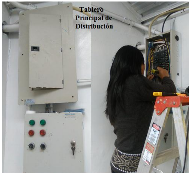
Figura 4. 37: Tablero principal de distribución.
