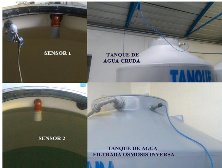
Figura 4. 35: Sensores MB7369 HRXL-MaxSonar-WRM instalados.
