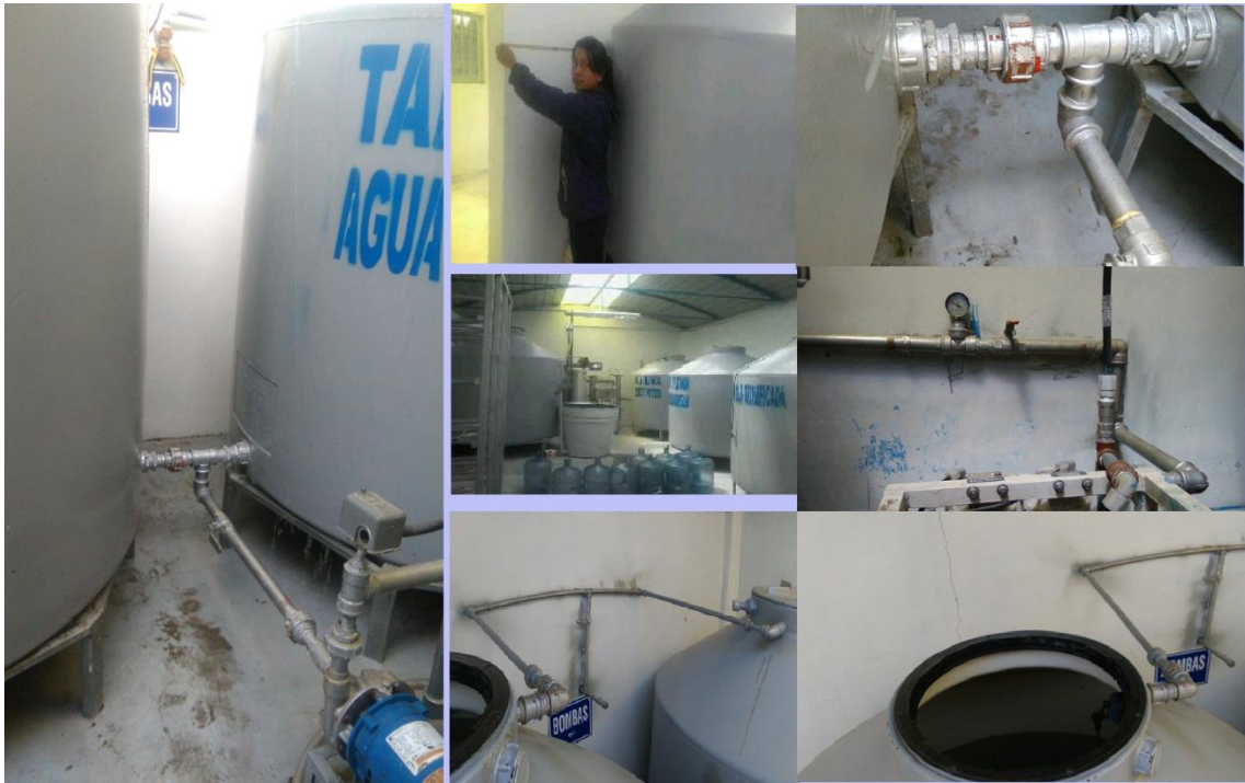
Figura 4. 61: Llenado de tanques de agua cruda y filtrada anteriormente.
