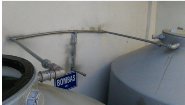
Figura 4. 25: Tubería de ingreso de agua de la red pública hacia los tanques de agua cruda, sección 1.
