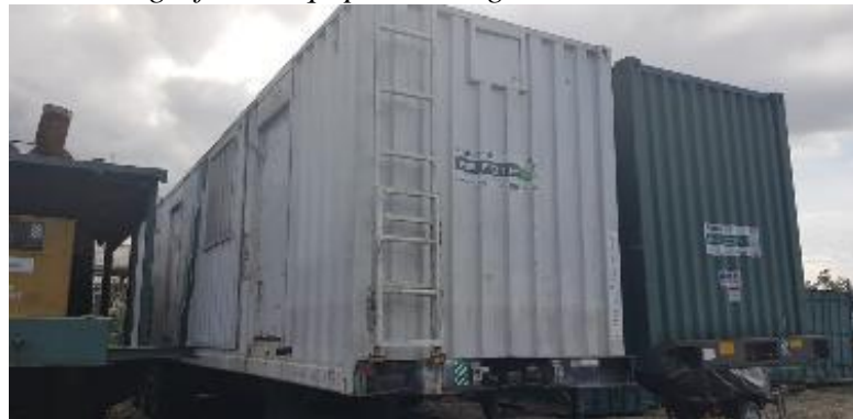
Fotografía 2. Equipo electrógeno insonorizado
