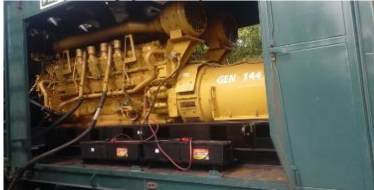
Fotografía 1. Equipo electrógeno sin insonorización
