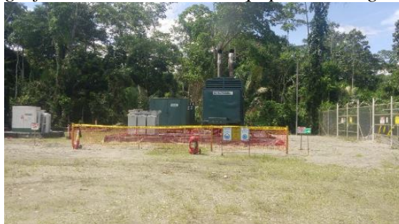
Fotografía 6. Señalización de equipos electrógenos
