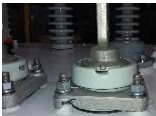
Fig. 39 Juego de sujeción bushing de alta, transformador trifásica subestación 2000kva; tuerca y rodela de presión galvanizadas de 3/8" [18].
