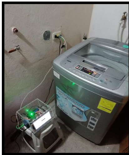
Figura 4-53 Equipo conectado a carga residencial (lavadora)
