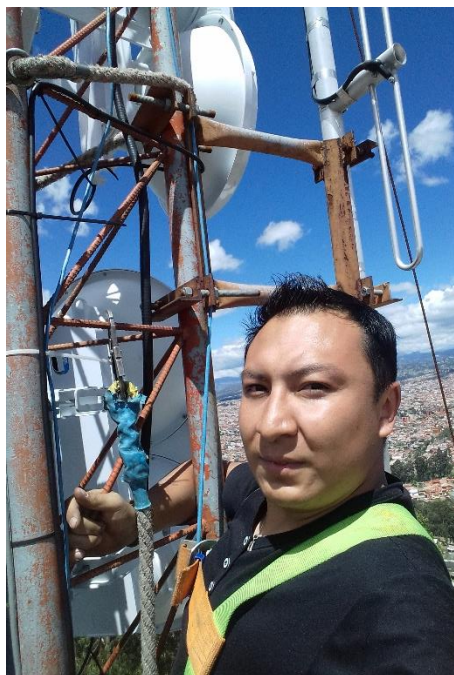
Figura 29 Colocación de Antena Esclavo en la Torre Elaborado por: Investigador
