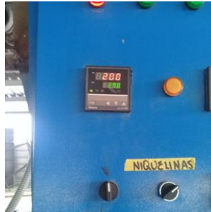
Figura 3.6 Panel de control de temperatura.
