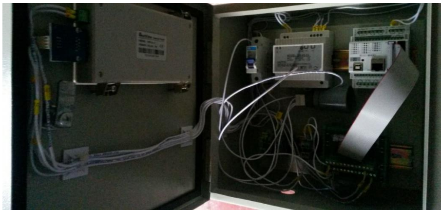
Figura 4.59: Distribución ordenada de los elementos en el riel din Elaborado por: Oscar Analuisa
