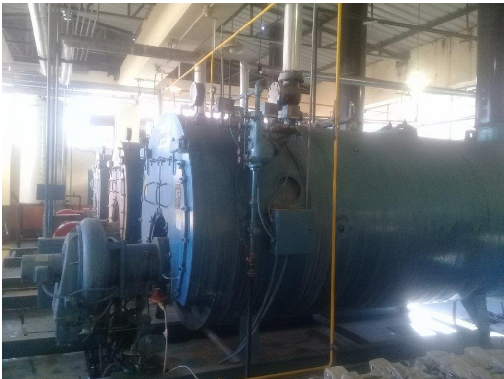
Figura 4.3: Caldero marca Superior Boiler Works
