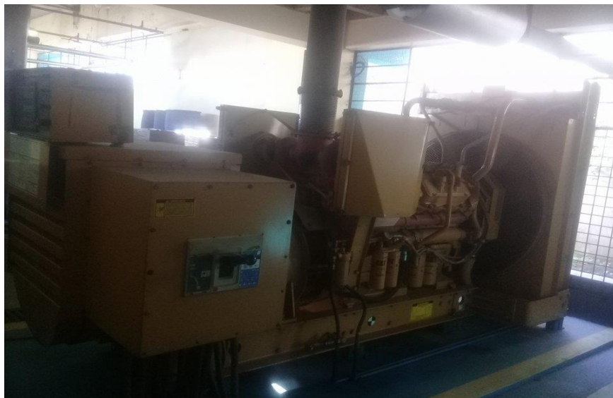
Figura 4.2: Generador Eléctrico marca Caterpillar modelo 3412
