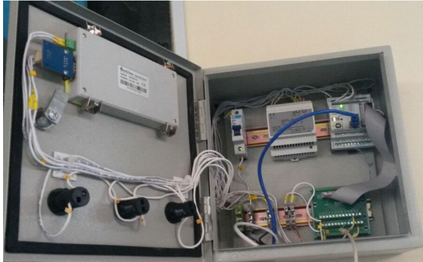
Figura 4.60: Instalación de tres las luces indicadoras para las alertas Elaborado por: Oscar Analuisa
