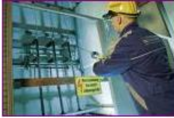
Figura 2 - Persona frente a un posible arco eléctrico.
