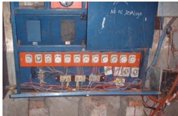
Figura 12 - Instalación en la que podría producirse una sobrecarga.
