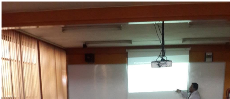
Figura 22. Para la visualización nítida de imágenes proyectadas se requiere apagar las luminarias para reducir el nivel de iluminación, dificultando el desempeño de las actividades académicas. Las imágenes se proyectan sobre la pizarra, con alta reflectancia especular. Estas condiciones potencia la aparición de deslumbramientos y molestias a los ojos.
