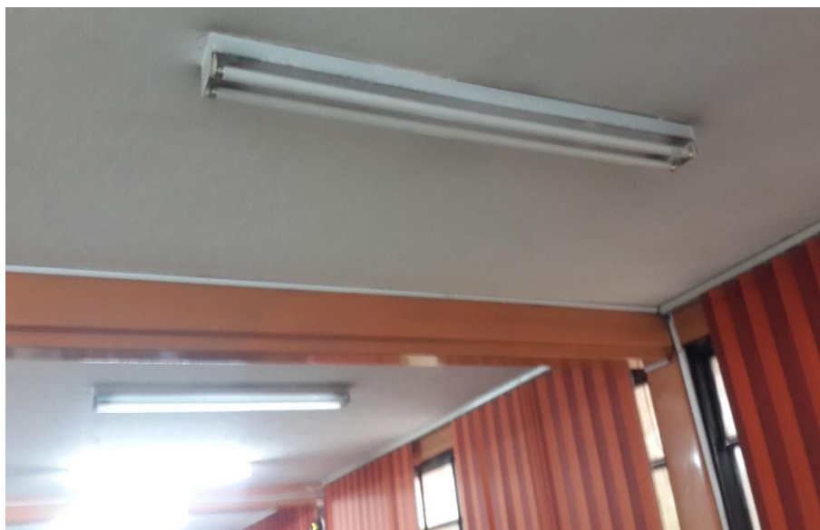
Figura 18. Presencia de luminarias fundidas, sin pantallas ni difusores, con presencia de polvo.
