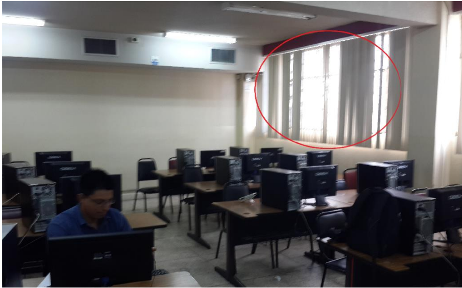
Figura 19. Persianas verticales para control de luz solar en laboratorios de la facultad de Ingeniería en Sistemas. Ausencia de algunas láminas en la persiana; conjunto comando, cadena de control y varilla de deslizamiento averiadas. Posible deslumbramiento por diferencia de contrastes de la ventana con el entorno.
