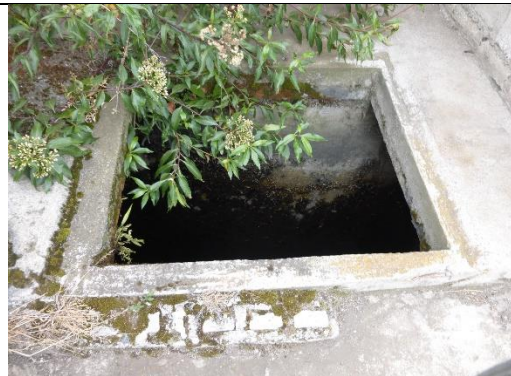
Tanque 2 (sin tapa) de reserva de agua de regadío para el funcionamiento operativo de la Industria.
