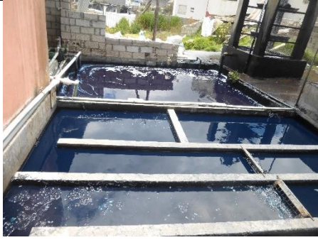
Planta de Tratamiento con la que cuenta la Industria, y es de ese lugar en donde se tomó la muestra para analizar el agua cruda.
