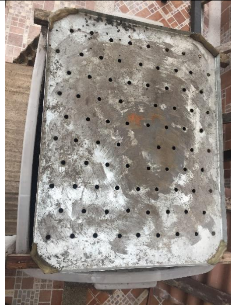
Bandeja metálica para la repartición del agua en el filtro
