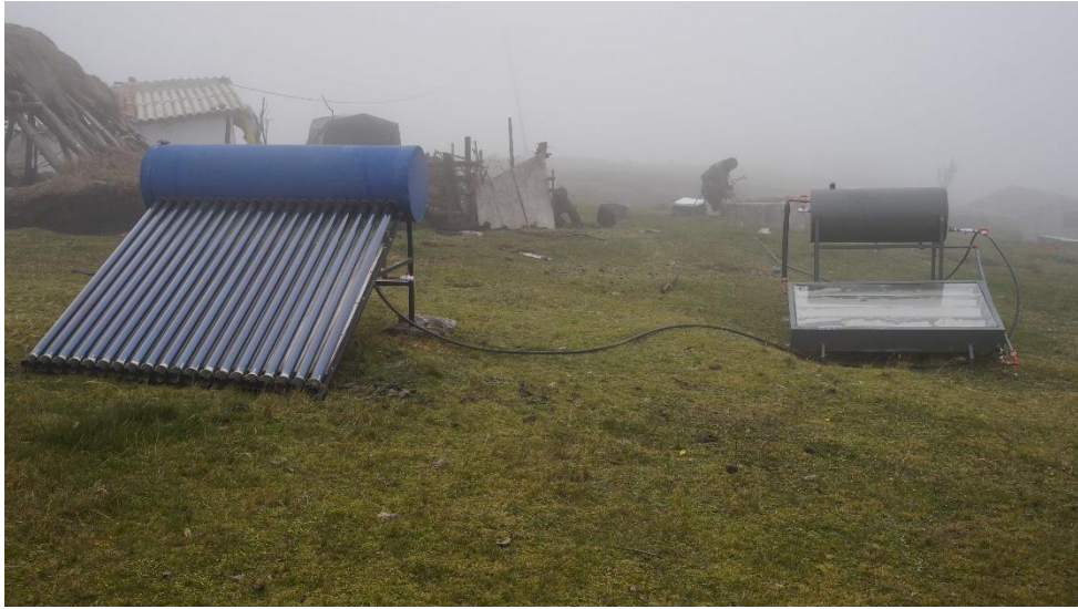
Figura 39. Sistemas instalados en la zona de estudio
