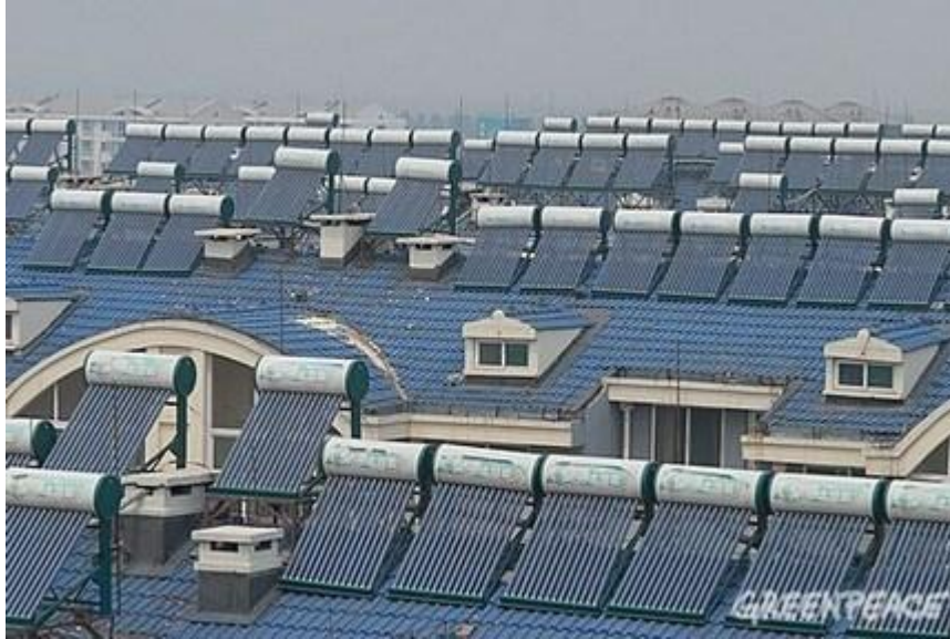
Figura 20. Colectores solares en China
