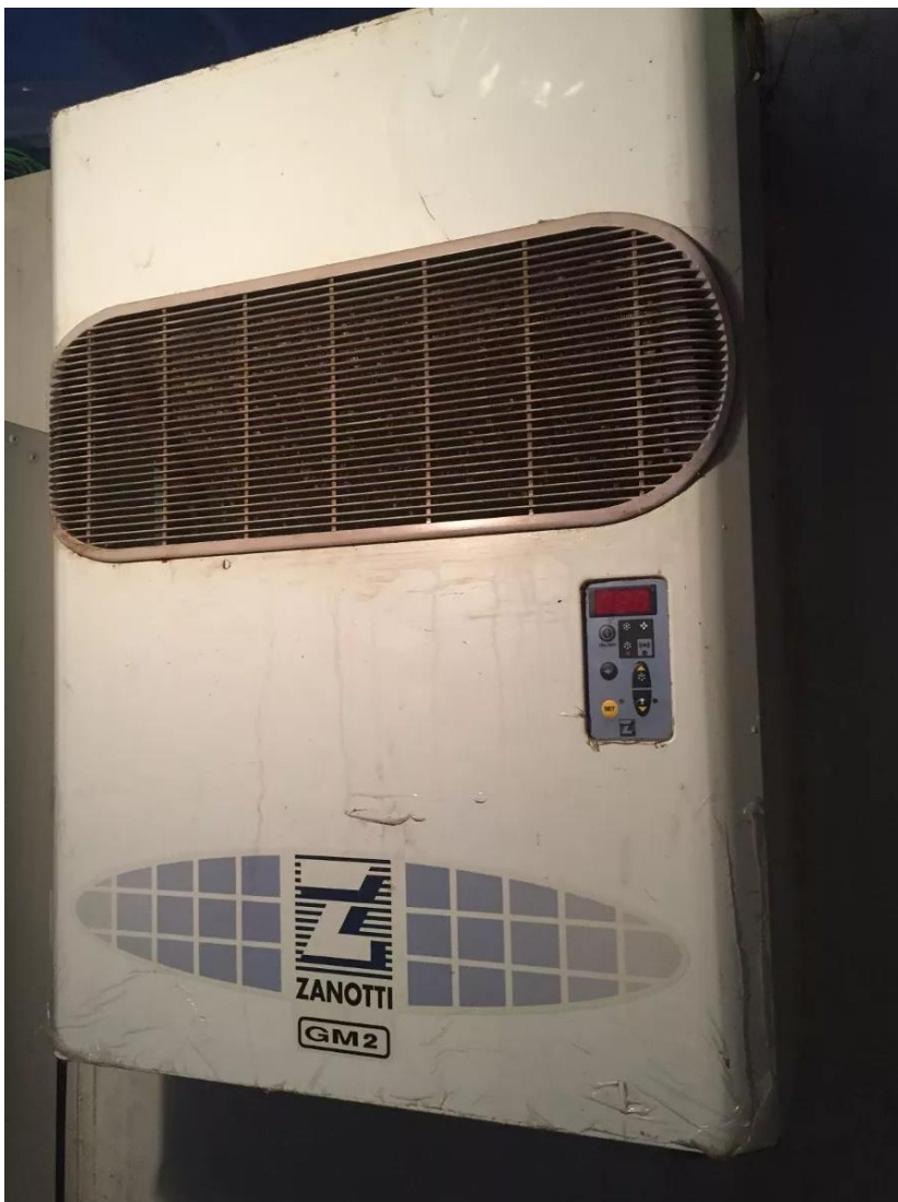
Ilustración 3: Cámara de refrigeración
