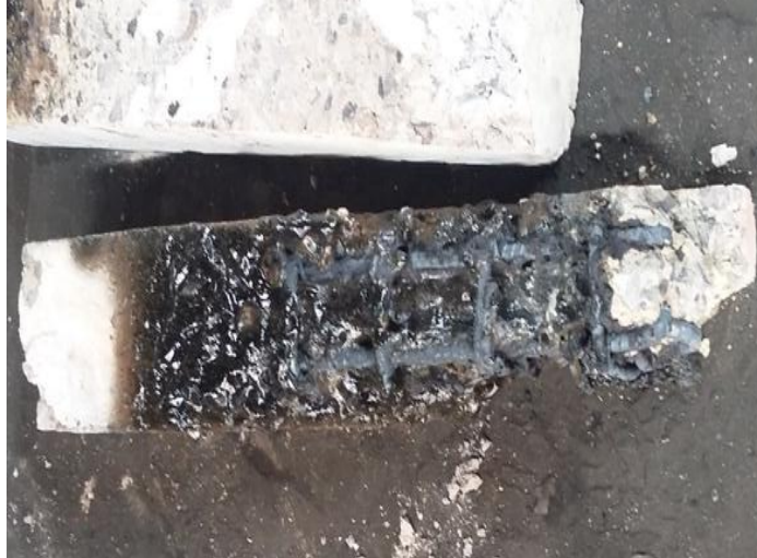
Anexo 22. Rotura del hormigón para la obtención de los aceros de refuerzo.
