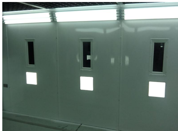
Figura 3.63: Ensamble de lámparas T8 y de mantas filtrantes de plenum.
