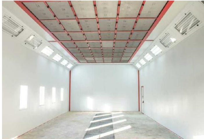
Figura 2.2: Configuración de filtros de carbono situados en el plenum (cabina de filtración seca) [3].
