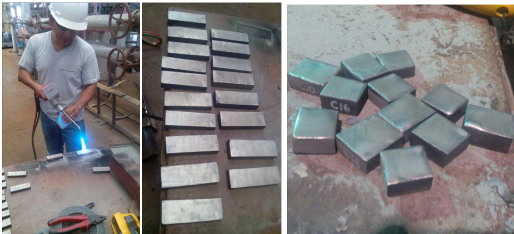
Figura 4. 25. Blindaje de probetas por proyección térmica de aleación metálica micro pulverizada EUTALLOY 11496
