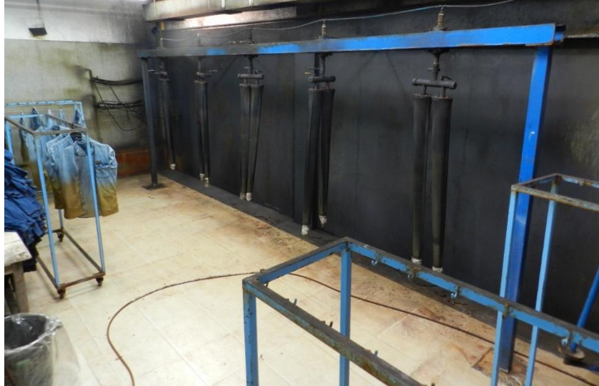
Figura 6.13. Área de sand blast químico del jeans, para implementación de la cabina con cortina de agua
