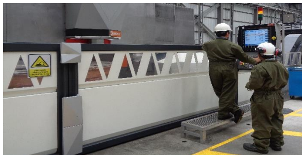
Figura 3-16. Puertas y barandillas de seguridad Fuente: [Autor]
