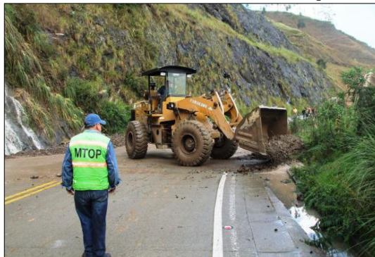
Figura 37: Mantenimiento rutinario. Remoción de suelos que obstruyen la calzada.
