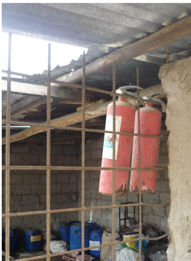
Anexo 14 Extintores de la Curtiduría Maral-Pi
