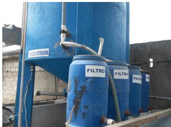
Fig. 23 Tanque de Floculación
