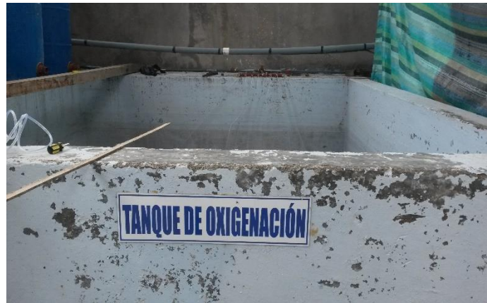
Fig. 22 Tanque de oxigenación
