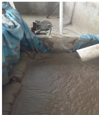
Fig. 24 Zona de Deshidratación de lodos
