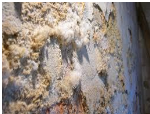
Fuente: Néstor Raúl Torres, Patologías 2009
