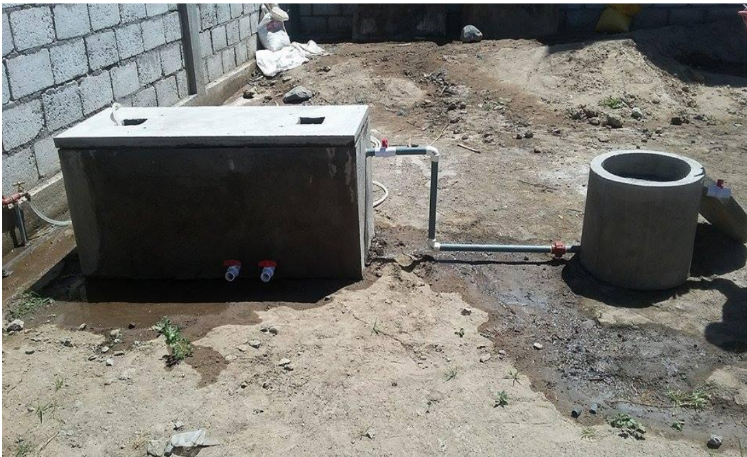
Tanque Séptico y filtro biológico
