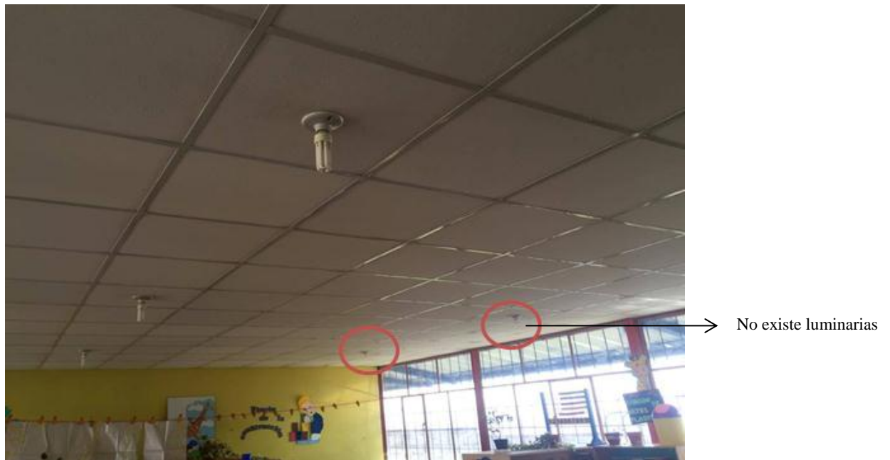
Figura N° 64: Condiciones de las luminarias
