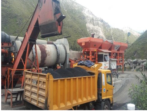
Planta Asfáltica JEAL Construcciones.
