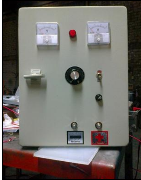
Figura 2.11 Rectificador de corriente para procesos galvánicos Fuente: (Electroquímica Galvano)
