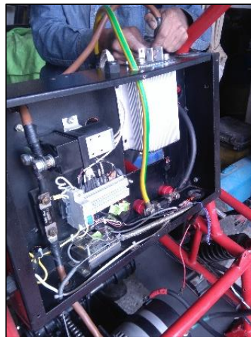
Figura 63 : Ubicación del controlador
