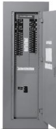
Figura No. 6.11 Tablero de distribución Fuente: grupoascencio.com/wp-content/uploads/2015/03/squared.pdf
