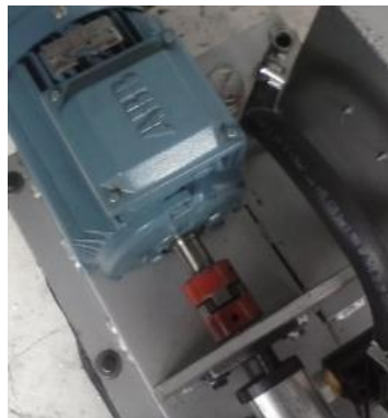
Figura 41. Acoplamiento entre motor-bomba
