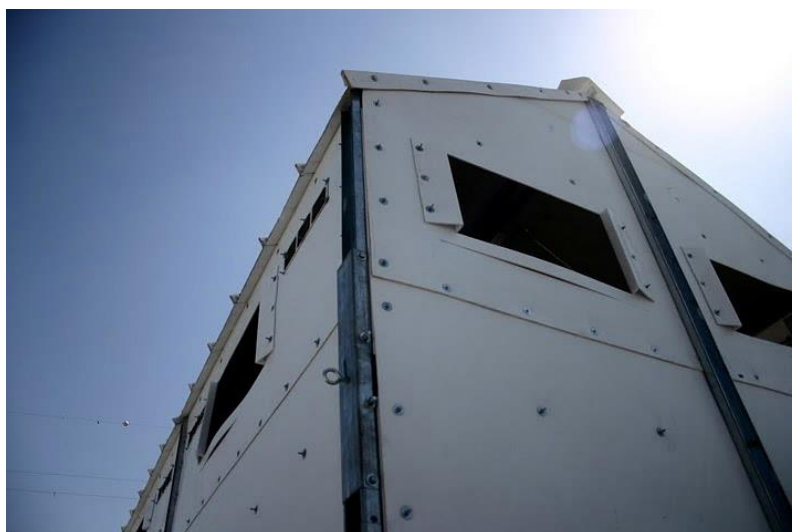
Fotografía N° 1: Albergue de Estructura Metálica Fuente: Laurel Cummings, (2011)
