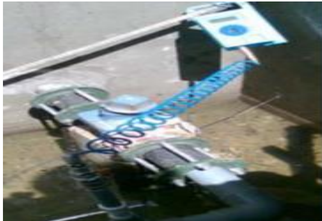
FIGURA N° 15 INSTALACIÓN DE DATA LOGGER
