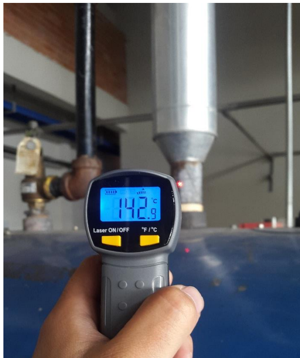
Figura 4-2. Temperatura del vapor a la salida de la caldera
