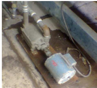
Fig 18: Bomba de Alimentación de agua
