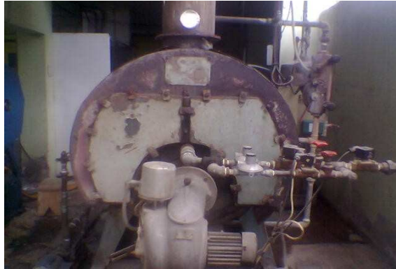
Fig 15: Caldero de LN
