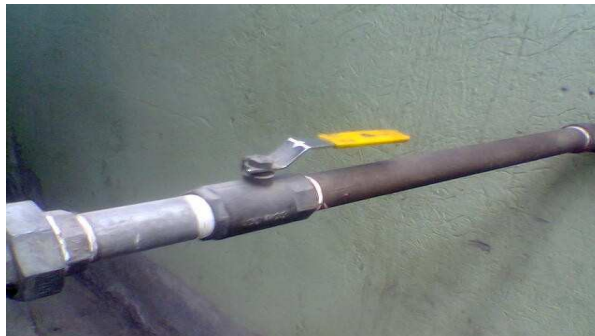
Fig 17: Válvula de Seguridad Alimentación de combustible
