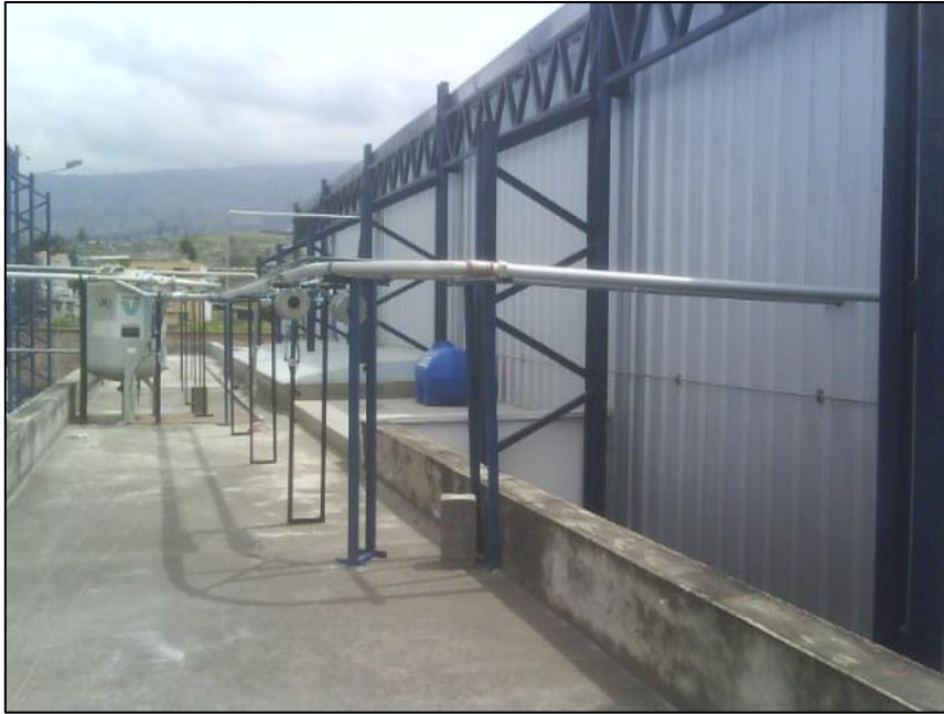
Figura 6. 85 Instalación de tuberías en que se interconectan ambas secciones Elaborado por: El Investigador
