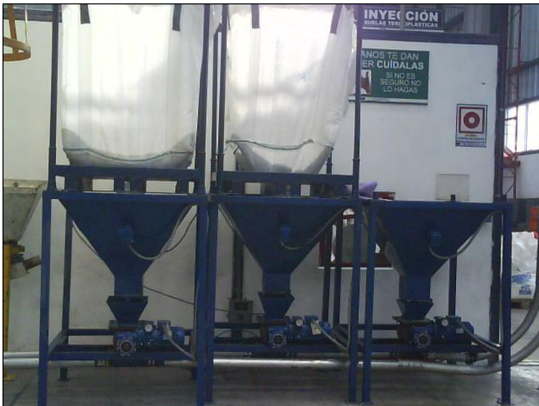
Figura 6. 82 Implementación de tolvas, tuberías y válvulas rotatorias
