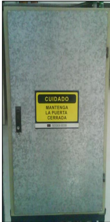
Figura 6. 90 Señalización del tablero de control Elaborado por: El Investigador
