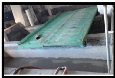
Tratamiento del agua
