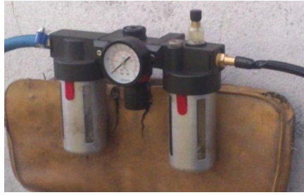
Figura 3. 9.- Unidad de mantenimiento de aire(Autor)
