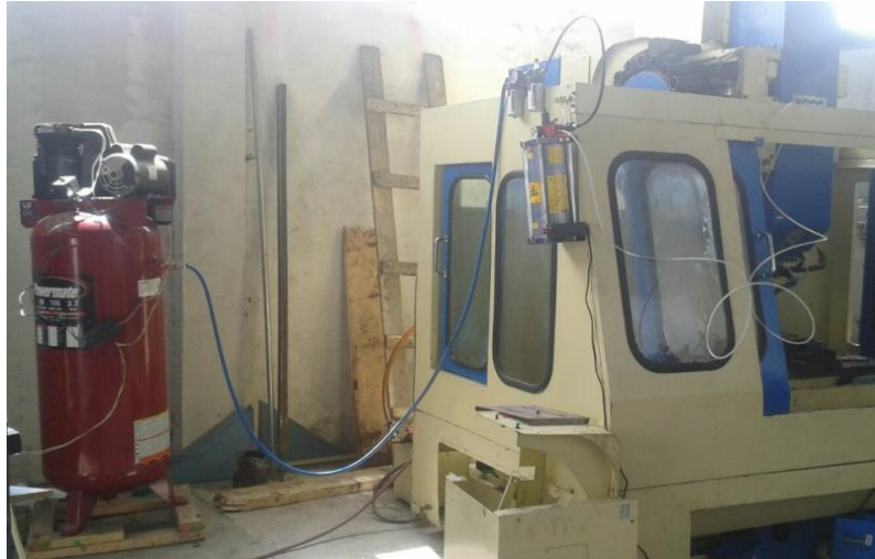
Fig. 3. 8: Sistema MQL Miquel instalado en el centro de mecanizado KIA KV40A (Fuente: Autor)
