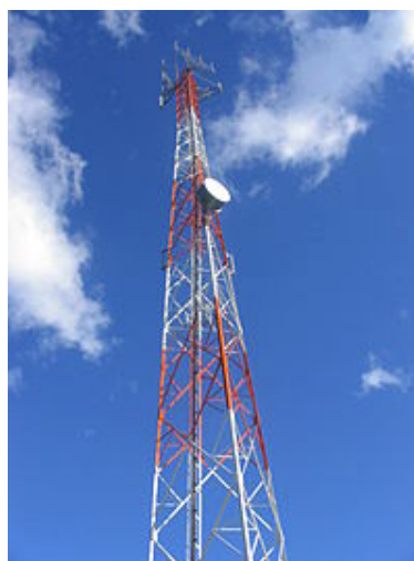
Detalle de antena repetidora de comunicación de datos.
