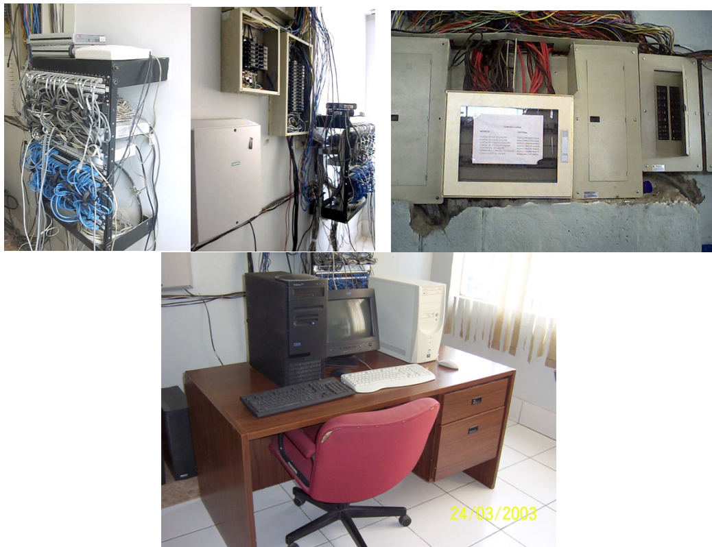
Equipos utilizado en el 2004
