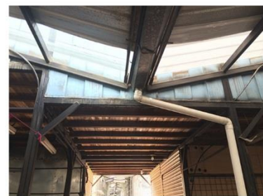
BAJANTE DE AGUA LLUVIA ESTADO ACTUAL
