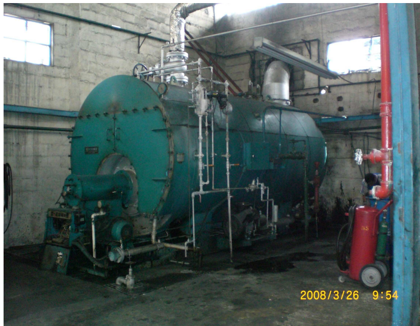
Foto 53. Calderos de Aceite Térmico
