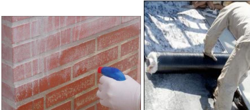
Figura 6.49 Humedecimiento de las juntas con un aspersor y cubrimiento del muro con láminas de polietileno para curado y protección contra la lluvia
