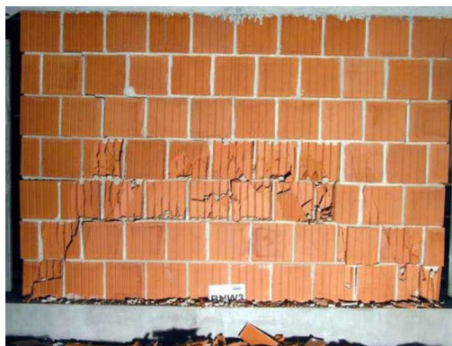
Figura 4.16 Falla por flexión
