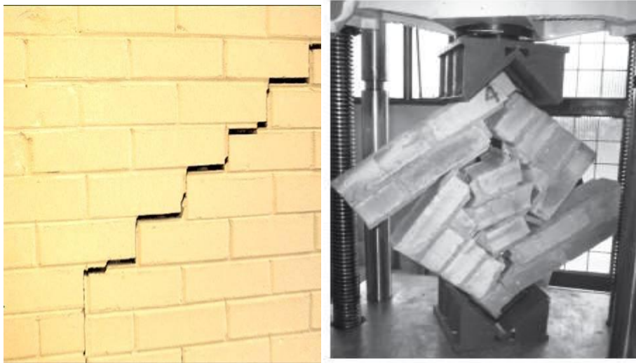
Figura 4.17 Falla por cortante y tensión diagonal
