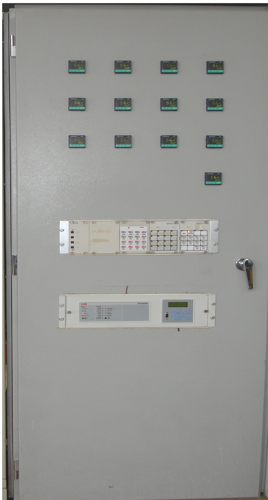
ANEXO 15. Vista frontal del tablero de los sensores de temperatura.
