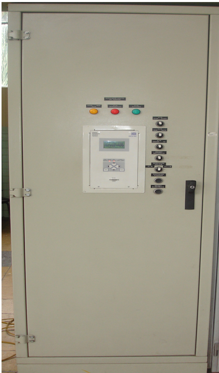
ANEXO 13. Vista frontal del tablero del PLC.
