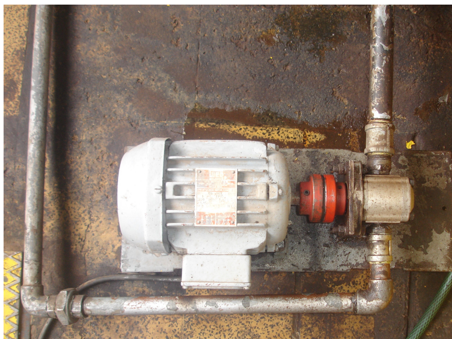
ANEXO 26. Motor de lubricación del Grupo # 3, en funcionamiento
