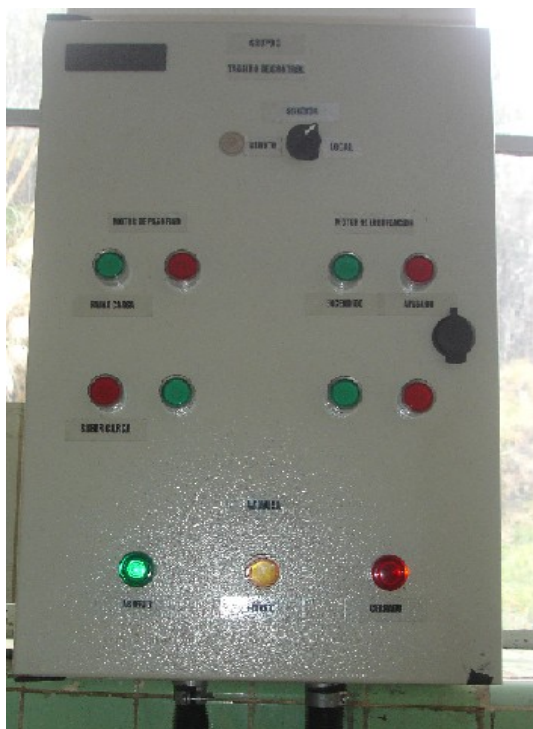
ANEXO 27. Accionamiento de la abertura de la válvula del Grupo # 3
