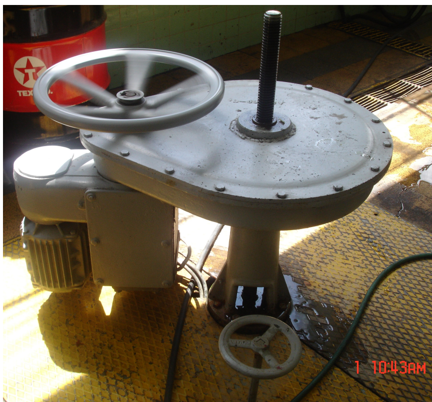
ANEXO 28. Válvula del Grupo # 3, en funcionamiento
