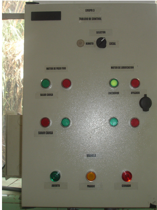
ANEXO 22. Vista frontal del tablero de control industrial instalado para el grupo # 3 en la Central Península.
