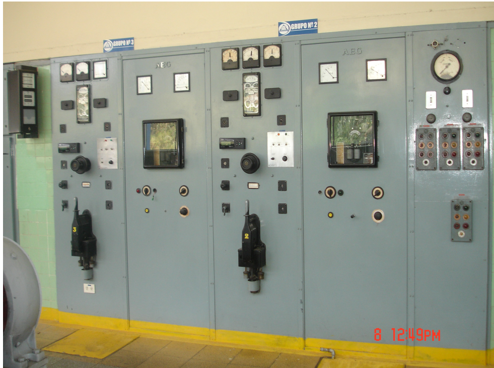
ANEXO 16. Tablero de control general de los grupos Generadores 2 y 3 de la Central Península.
