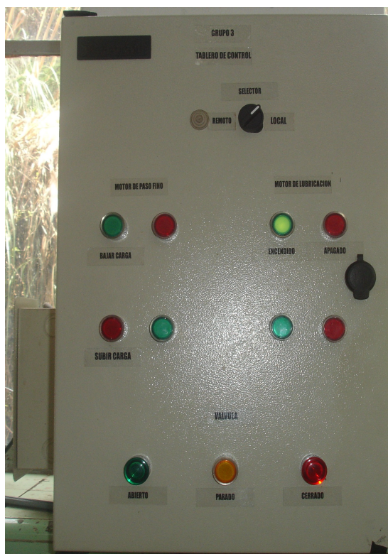
ANEXO 25. Accionamiento del encendido del motor de lubricación, Grupo # 3
