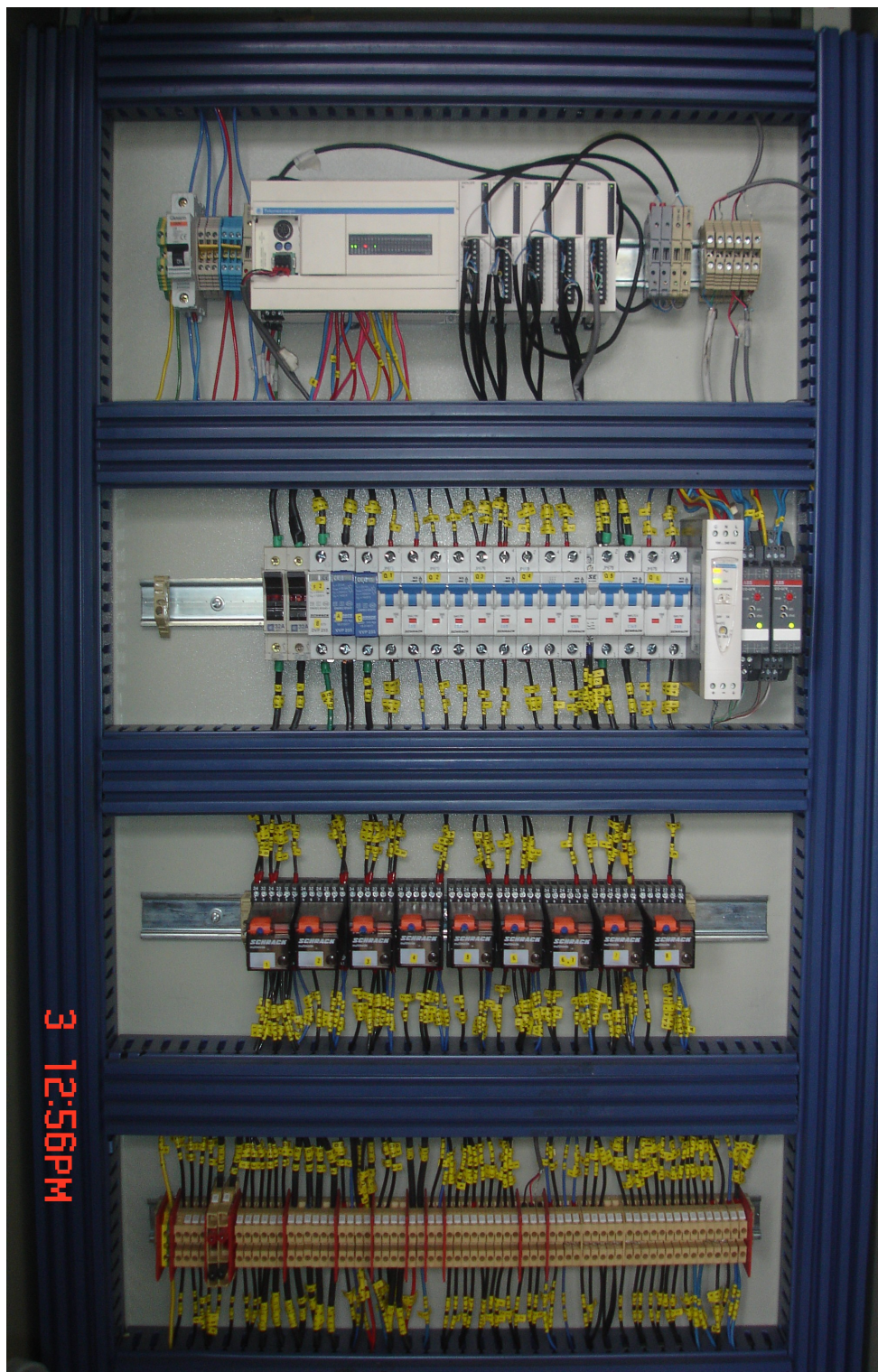
ANEXO 14. Vista interna del tablero del PLC.
