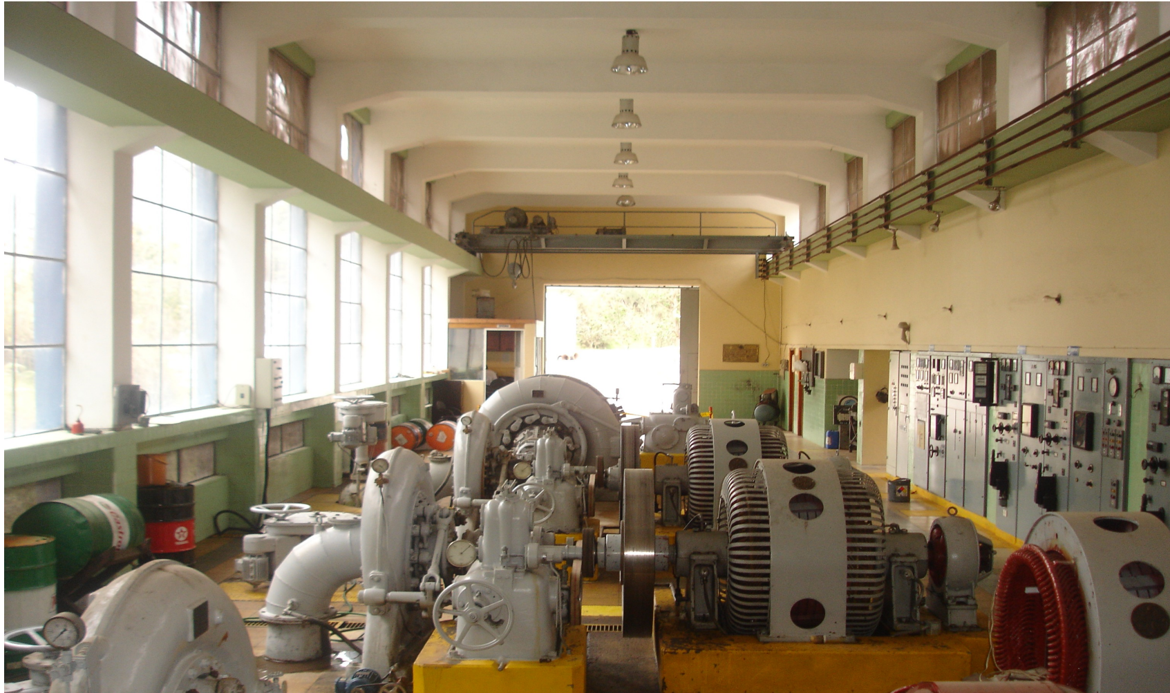
ANEXO 11. Grupos Generadores de la Central la Península.
