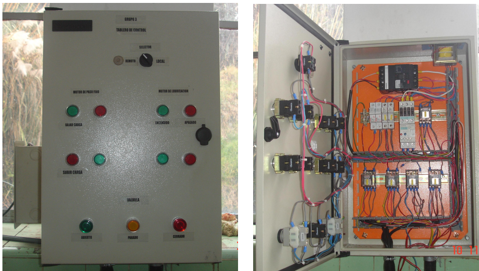
Fig. 30.- Tablero de control. Instalado en la Central Península
