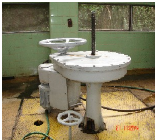
Fig. 36.- Válvulas de compuerta de la Central Península.
