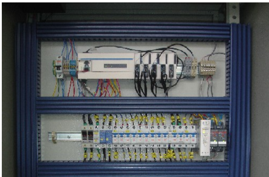
Fig. 54.- Hardware utilizados en el Sistema de Control de la Central Península
