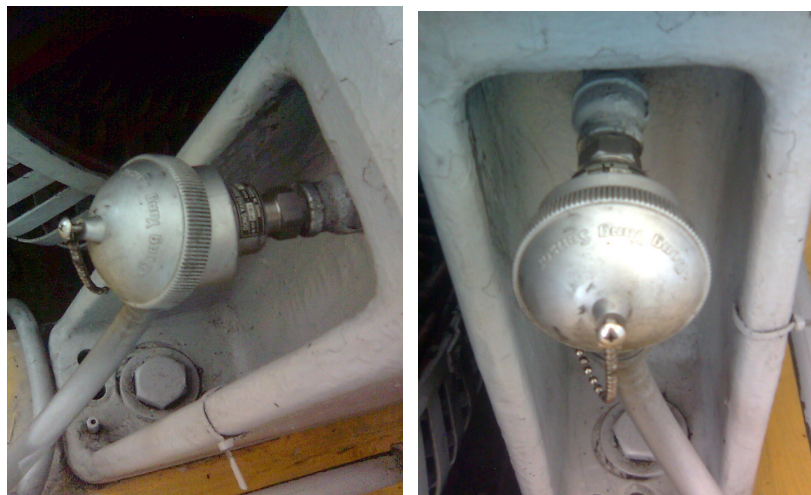
Fig. 4.- Termoresistencias de la Central Península
