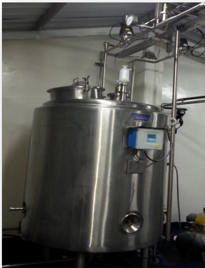
Tanques de acero inoxidable.
