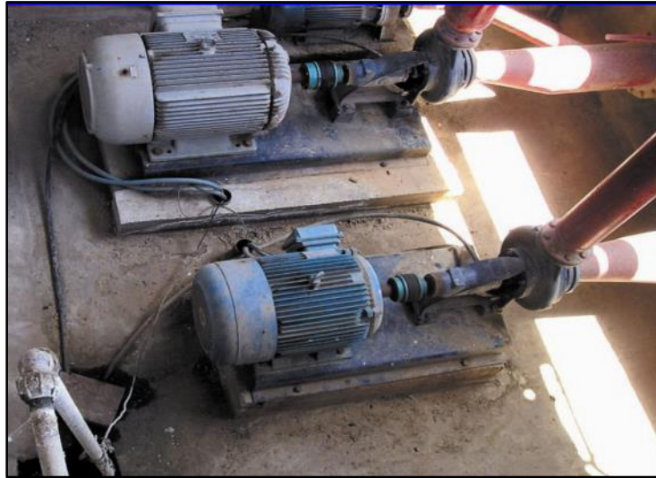
Figura 2.10 Conjunto de bombas centrífugas
