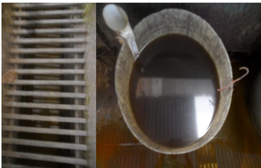
Fig. 5 Recolección de las aguas residuales
