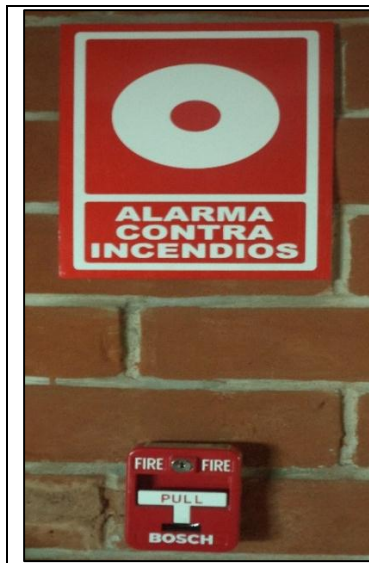
Fig. 28. Pulsador de alarma
